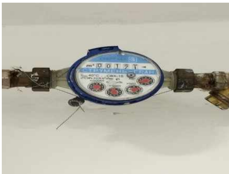
Счётчик водопотребления в детской комнате по ул. пр-т Текстильщиков -33
